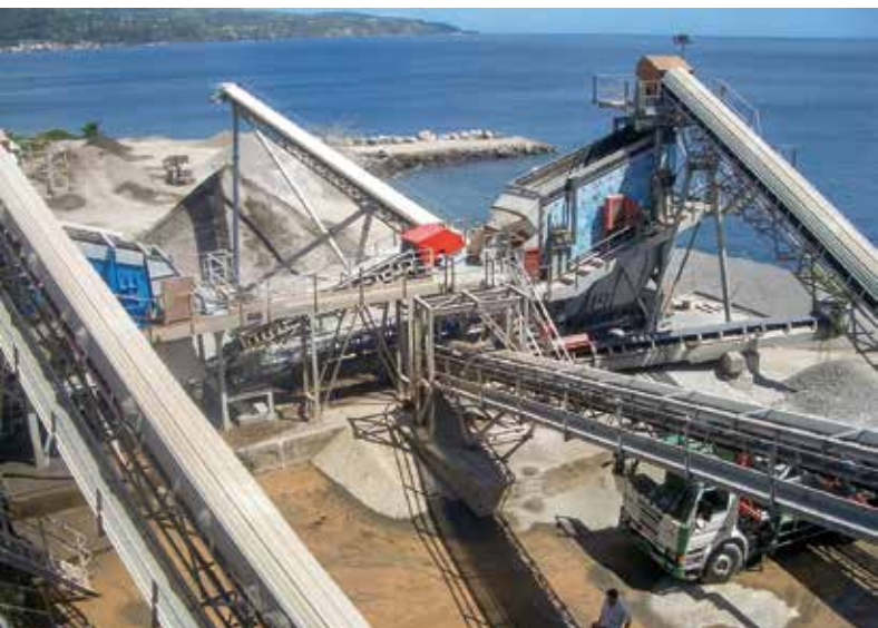
L'installation de traitement a été renouvelée en 2003. Elle est très proche du quai de chargement.
